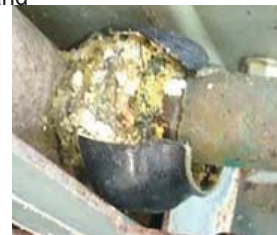
Galvanische Korrosion unter Kunststoffschlauch.
