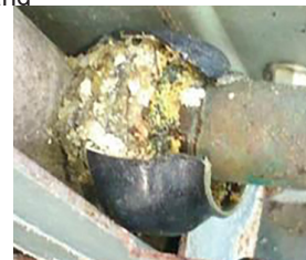
Galvanische Korrosion unter Kunststoffschlauch.
