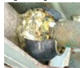
Galvanische Korrosion unter der Kunststoffhülse.
